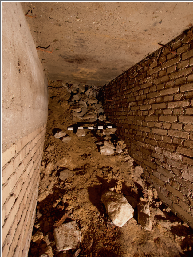
▲ Abb. 10 Erdreich, das nach dem Artilleriegranateneinschlag in den Tunnel eindrang und den zweiten Ausgang verschüttete
