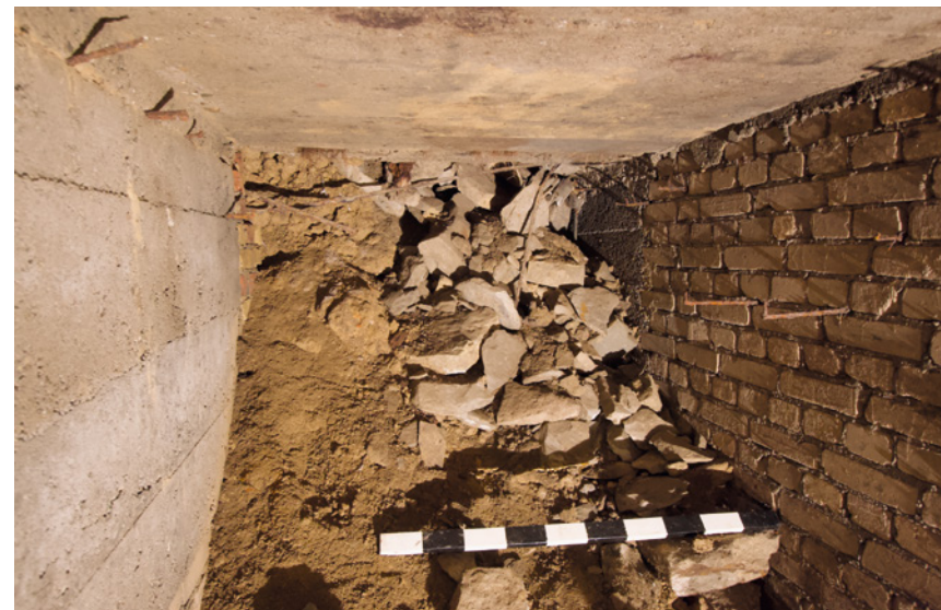
Abbildung 8: Blick auf den Einsturz, der den weiteren südöstlichen Abschnitt blockiert. Foto: Verf.
